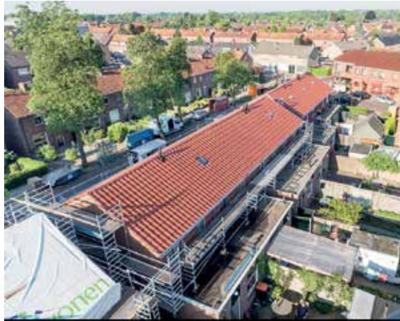
In Oldenzaal zijn 38 woningen gerenoveerd en die hebben onder andere beter geïsoleerde daken en een nieuwe pannenbedekking gekregen.
